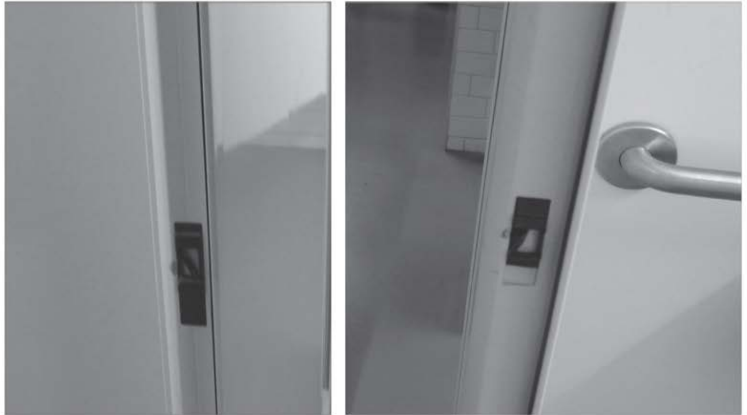
Les loquets défectueux étaient de plus en plus nombreux dans le pavion Lassonde
