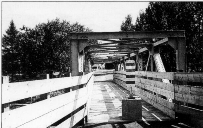
Plusieurs cyclistes se sont retrouvés au bout de ce pont sans savoir où ils se trouvaient. Aucune indication ne mentionnait qu'il s'agissait de la fin du circuit urbain de Saint-Félicien et non le tracé de la Véloroute des Bleuets.
