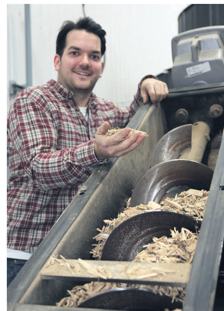
Les copeaux de bois montent dans la chaudière chauffant la biomasse à l'aide d'un système de vis sans fin.
