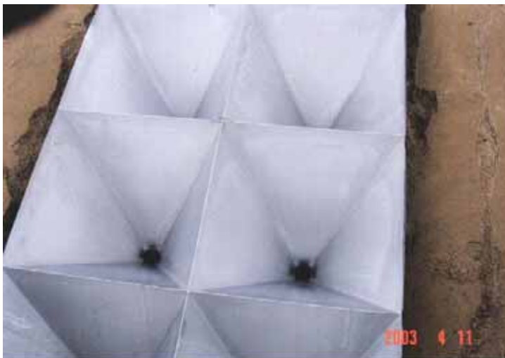
Figure 11. Cônes de sédimentation à la construction
