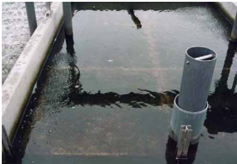
Figure 18. Section de biofiltre à l'arrêt
