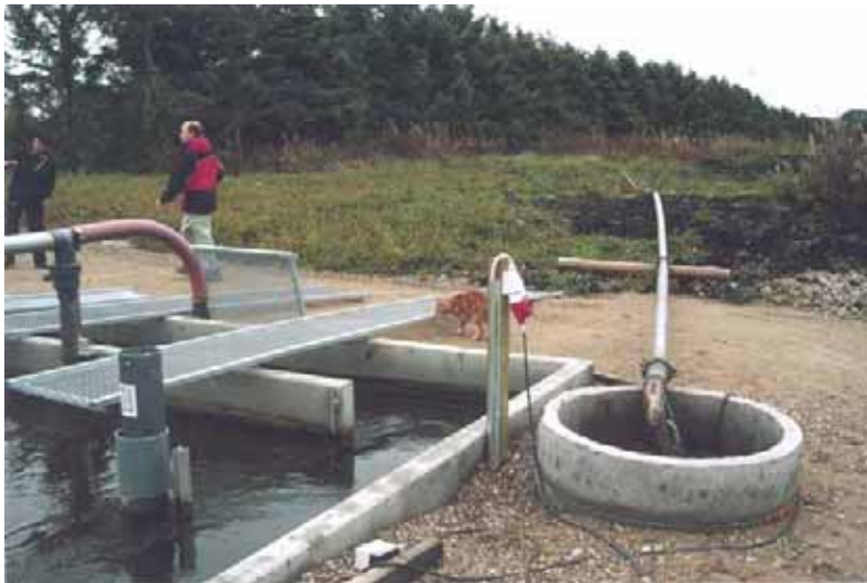
Figure 15. Puits de repompage des boues vers le marais filtrant
