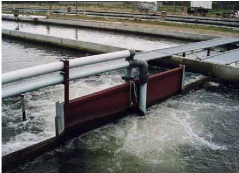
Figure 10. Puits d'aération et de remontée d'eau par émulsion d'air (« air-lift »)
