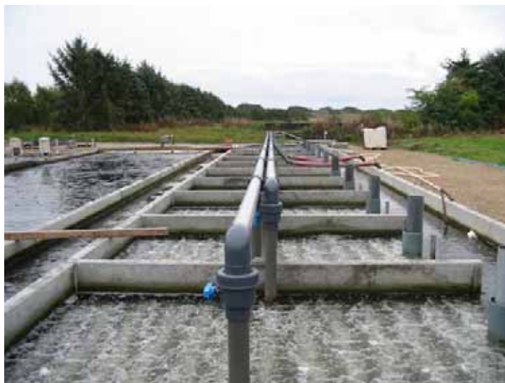
Figure 16. Biofiltre de type submergé à lit fixe
