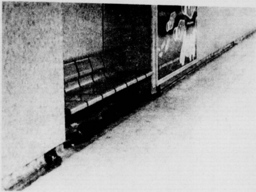
Ce n'est ni un chien qui a pissé, ni un enfant qui s'est laissé aller, c'est l'eau tout simplement qui coule lentement d'une fissure dans la rigole, avec un chuintement continu.
