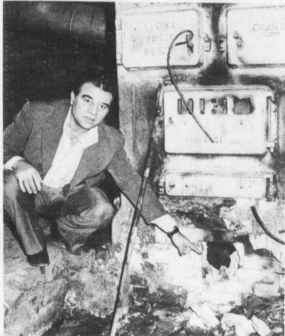
M. Ioannis Akrivas, locataire du Château Esplanade où il n'y a plus de chauffage ni d'eau chaude depuis deux semaines, indique le dommage infligé à la fournaise de l'immeuble hier matin lorsqu'un plombier est allé enlever le brûleur à l'huile.
