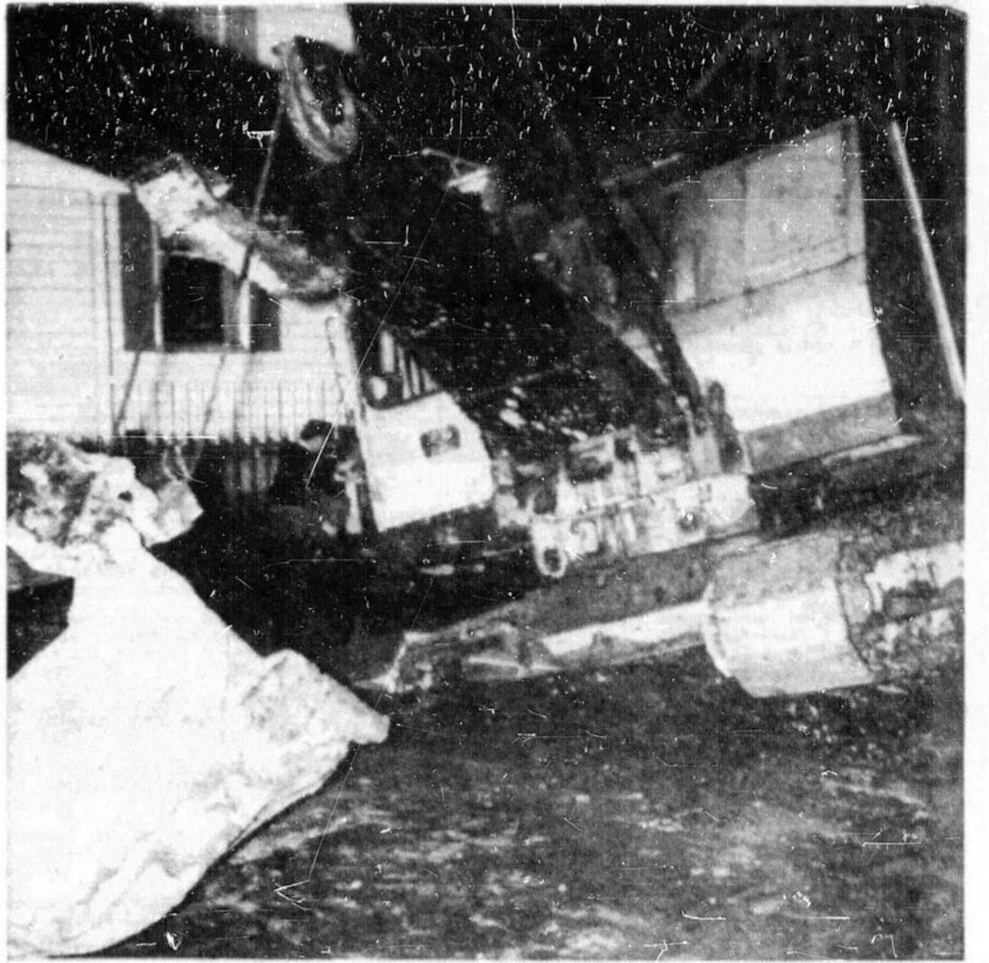
LA PELLE MECANIQUE A ENFONCE — L'éclatement d'un tuyau d'aqueduc de 20 pouces a causé tout un émoi vers les 8 heures hier soir, à l'angle des rues Berri et Laramée à Hull. Cette pelle mécanique, mandée sur les lieux pour y commencer les travaux de creusage, a enfoncé profondément dans le sol miné par l'eau. Les caves de deux résidences sur le boulevard Laramée ont été inondées.
