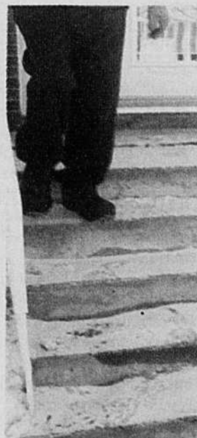
Un exemple d'un escalier mal entretenu.
