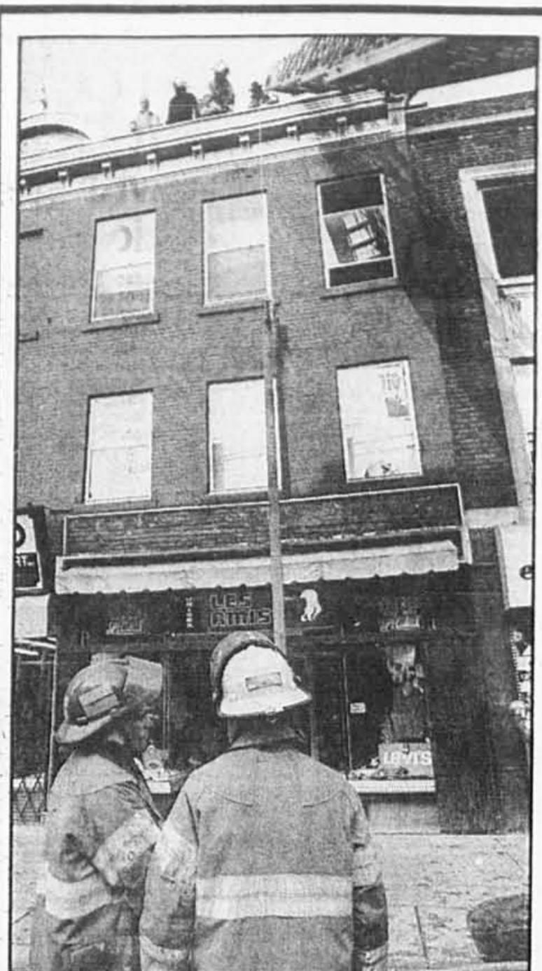
Les flammes ont surtout endommagé le dernier étage et la toiture de l'édifice voisin du club de danseurs nus «281» de la rue Sainte-Catherine.
