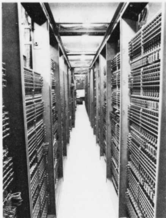
Une partie de l'équipement crossbar du central automatique de SOTEL INC. à LG 4.
