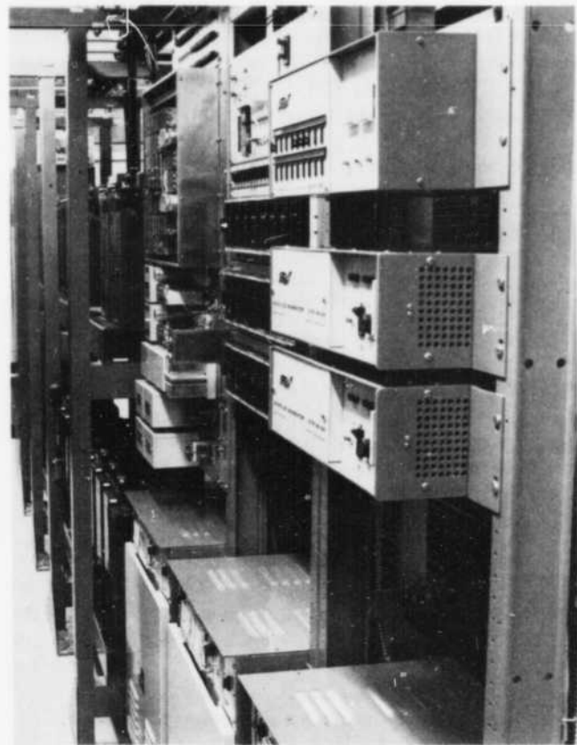
Vue de la section des redresseurs de courant et les accumulateurs du central de SOTEL INC. à LG 4.
