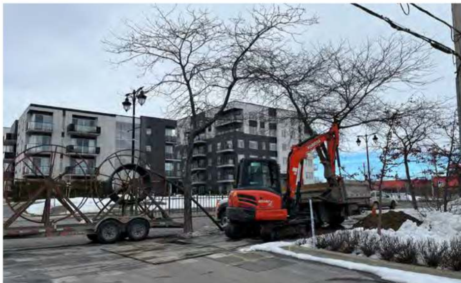
Des travaux semblables, pour la fibre optique, se sont déroulés la semaine dernière à Sainte-Julie. (Photo : Frank Jr Rodi)
