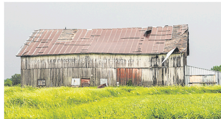
Plusieurs toitures ont été endommagées, comme celle-ci, à L'Ascension. — PHOTO LE QUOTIDIEN, GIMMY DESBIENS
