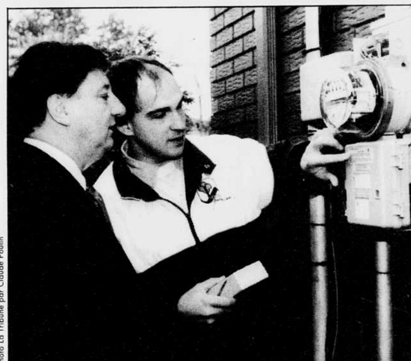
Le technicien d'Hydro-Sherbrooke, Denis Mailhot, explique à Alain Villeneuve, le 1000e abonné à adhérer au programme d'efficacité énergétique Double tarif, le fonctionnement du voyant lumineux relié au circuit de contrôle de son système de chauffage bi-énergie.
