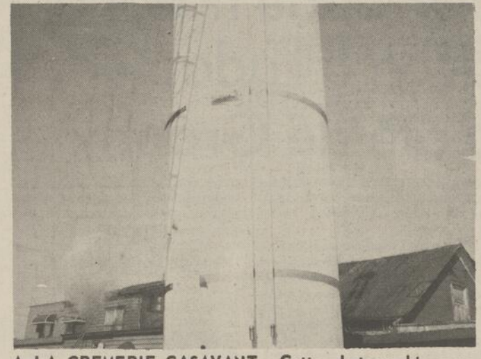
A LA CREMERIE CASAVANT-- Cette photographie nous donne une idée de la grandeur d'un réservoir pouvant contenir onze mille gallons de lait, installé à la crèmerie Casavant, de St-Césaire.
