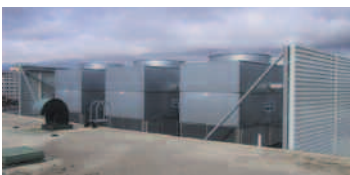
3.18 Tours de refroidissement
