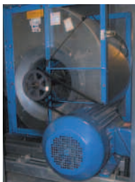
3.9 Ventilateur d'alimentation type centrifuge
