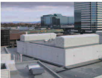
3.3 Cabanon persienne de prise d'air extérieur et/ou d'évacuation d'air
