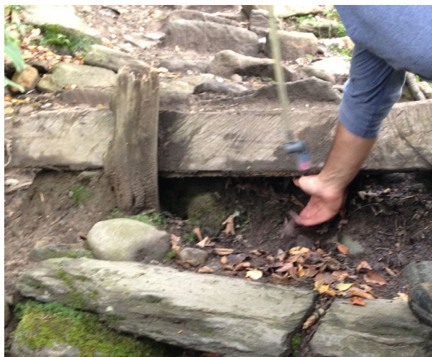
Perte de sol minéral sous une marche talus
