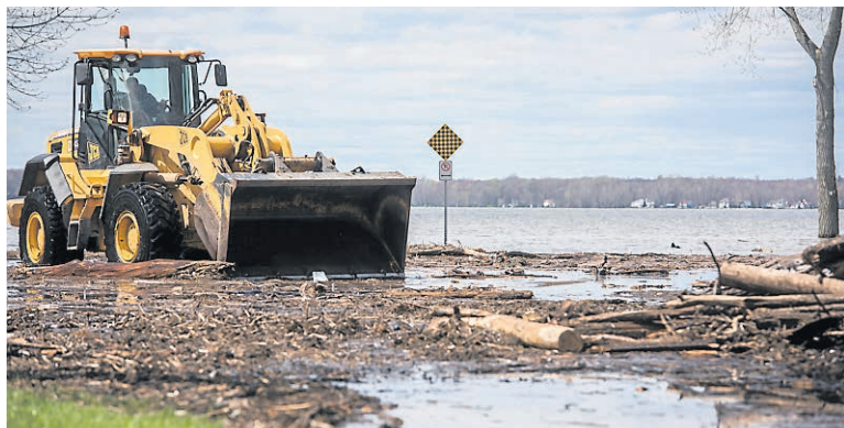
Alors que la situation des inondations semble vouloir se résorber, on se met déjà en mode nettoyage du côté de la Ville de Nicolet. — PHOTO: FRANÇOIS GERVAIS
