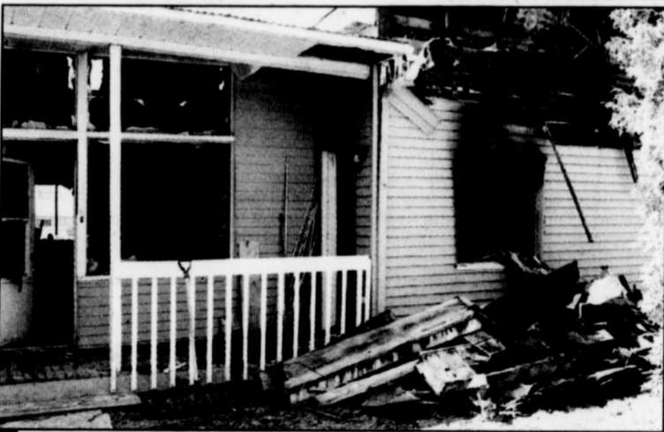
La façade du commerce a été lourdement endommagée par les flammes. (Photo: Prac)
