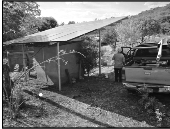
Dieciocho paneles solares para la red de agua de Las Pozas (Foto: Elmer Zelaya Blandón)
