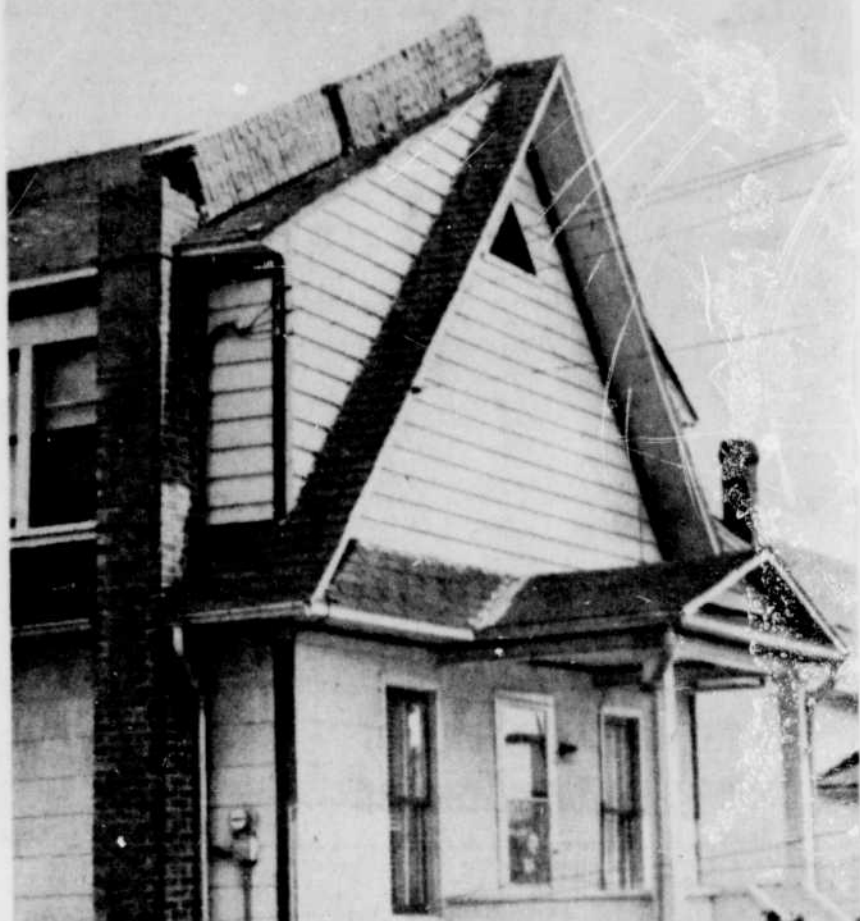
La cheminée penche "du côté d'où vient le vent". — De nombreuses localités de la Beauce ont été durement touchées, mardi, par une tempête qui s'est déchaînée en orage et a causé de lourds dégâts à divers immeubles, en particulier à St-Ferdinand, St-Pierre de Broughton, Black Lake, St-Côme, East Broughton. Cette photo illustre bien la violence capricieuse du cyclone qui a brisé la cheminée de la demeure de M. Joseph Paquet, à St-Côme, sans endommager le toit ou les murs.
