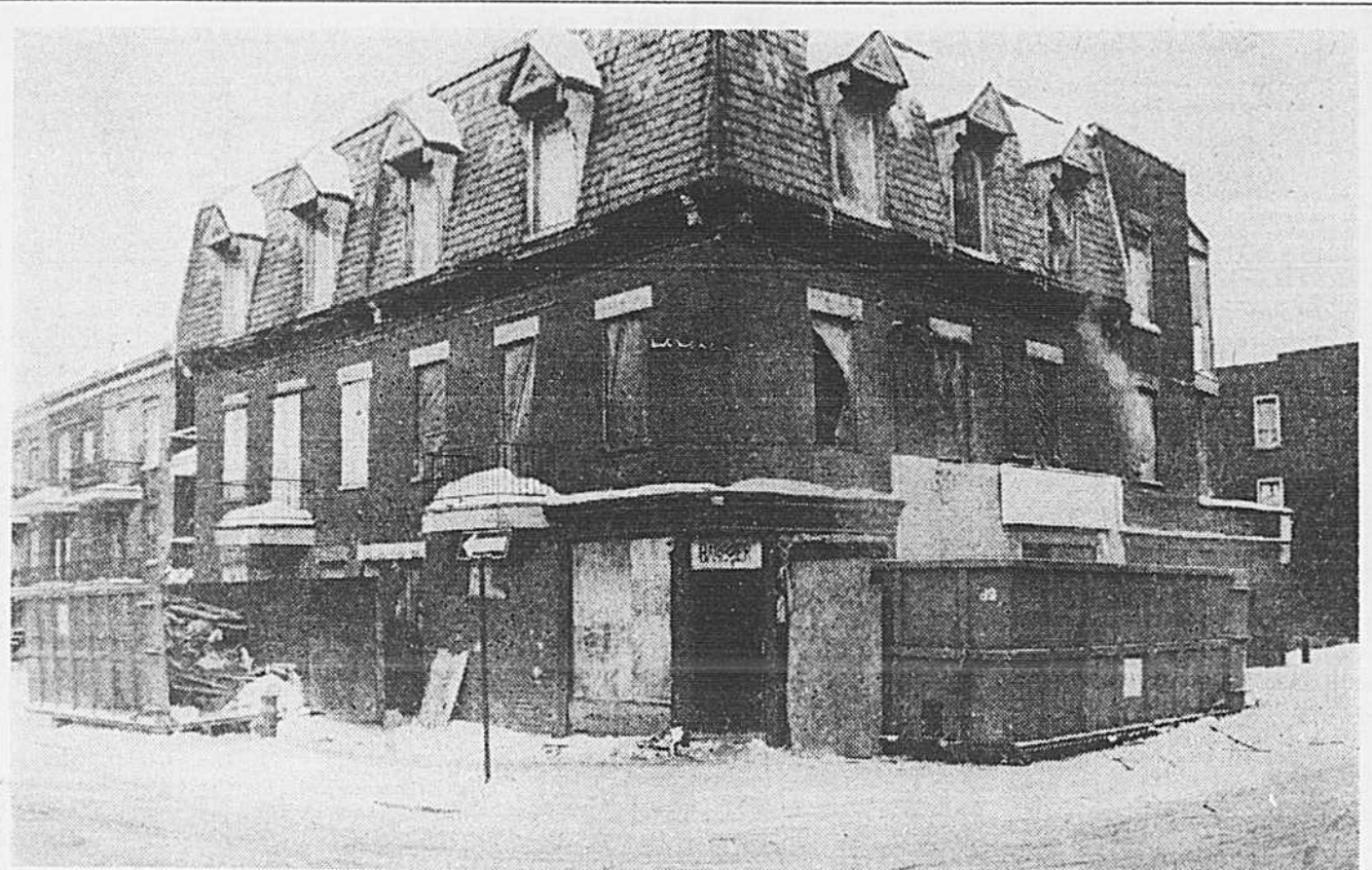
Cette maison située à l'angle des rues Adam et Saint-Germain a été acquise par un groupe de citoyens dont le député d'Hochelaga, M. Jacques Lavoie, afin de la transformer en logements pour les personnes âgées. Malheureusement, un vice de construction a empêché la poursuite des rénovations et on songe à la démolir.
