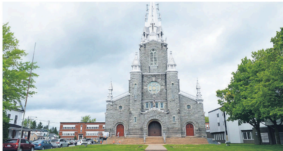
Construite il y a près de 100 ans, l'église Ste-Luce nécessite des travaux sur son enveloppe. (Photo Courrier Frontenac - Claudia Fortier)
