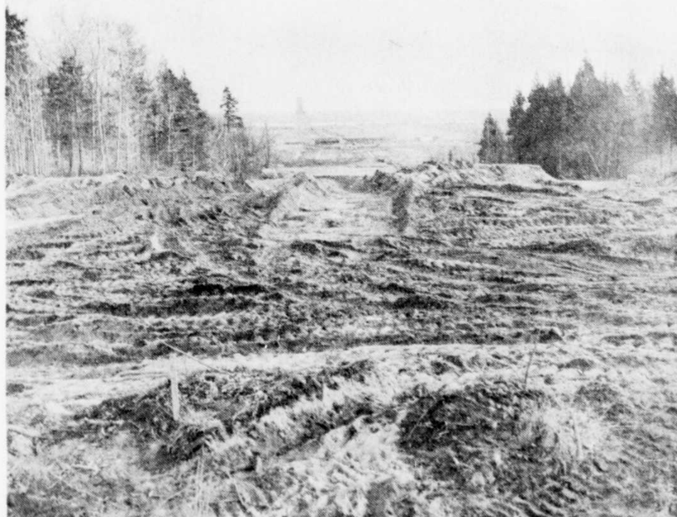
LA COMPAGNIE PAGE CONSTRUCTION, DE TROIS-RIVIERES, procède actuellement à la construction d'un tronçon de la Transquébécoise. Ce premier tronçon débute à la
