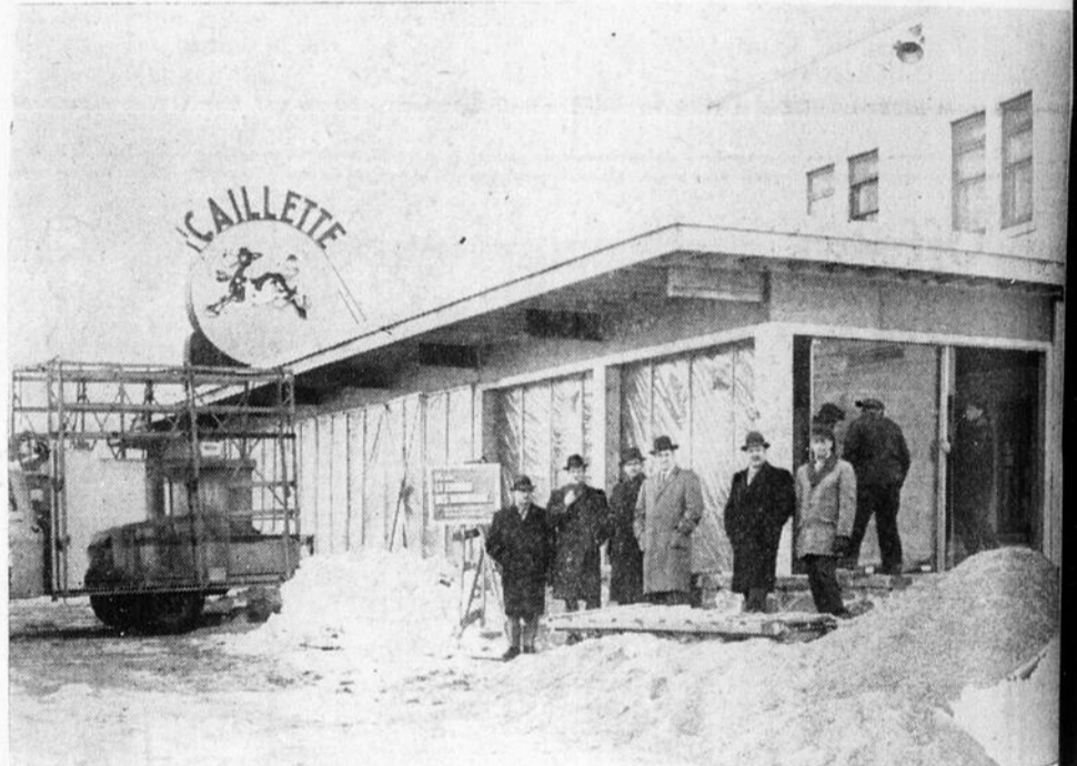
La construction d'un agrandissement aux "Produits Caillette" de Maskinongé s'est faite durant la saison froide et a ainsi procuré du travail à plusieurs personnes.
