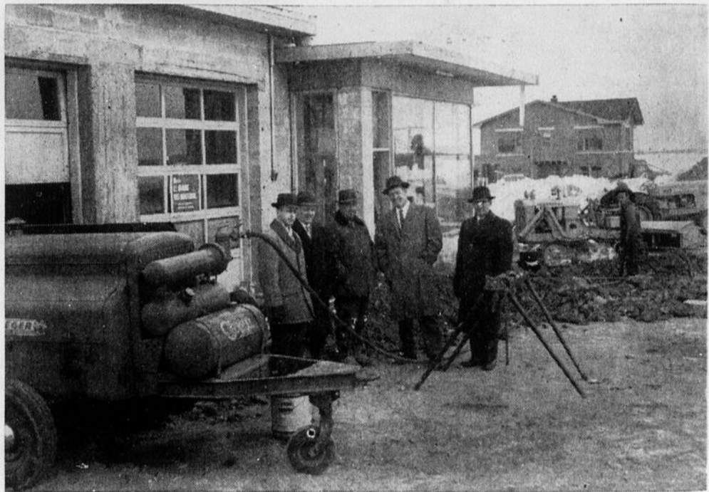
Les travaux de construction du nouveau Garage J. C. Roberge se poursuivent toujours malgré la saison froide et procure ainsi du travail à quelques 10 employés.
