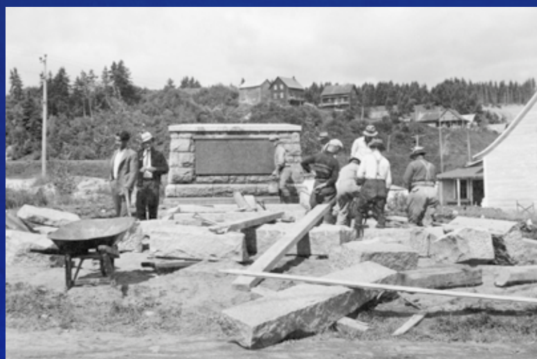
Construction du monument du Côteau-du-Portage, en mémoire aux voyageurs ayant emprunté la rivière Chicoutimi, 1937.
