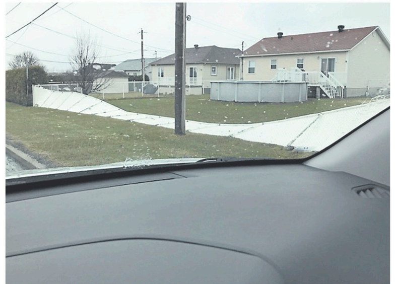
En raison de la neige tassée, la structure s'est affaissée. — PHOTO FOURNIE
