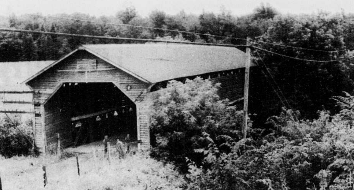
La population de Warwick assiste impuissante au délabrement du seul pont couvert sur le territoire des Bois-Francis.
