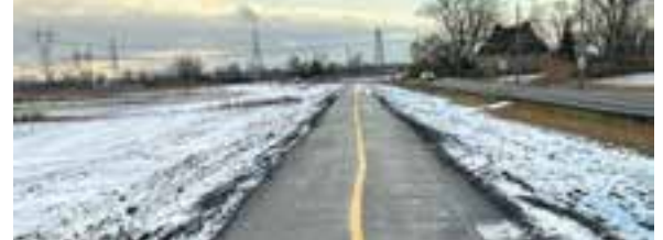
Resurfacement et construction de la piste cyclable (phase 1) sur la montée Sabourin (1,8 M $)
