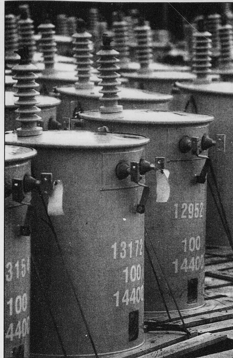
Téléphoto, par Claude Croisetière Les nombreux orages ont fait sauter bien des transformateurs d'Hydro-Québec; l'aide d'Hydro-Sherbrooke a même été nécessaire à la société d'État à la suite des bris de transformateurs survenus en fin de semaine dans la région.
