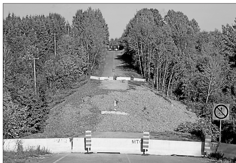
Démoli en octobre 2015, le pont du chemin des Laurentides devrait être reconstruit d'ici 2018. En attendant, il cause des maux de tête aux équipes de déneigement à Saint-Boniface. —PHOTO: SYLVAIN MAYER.
