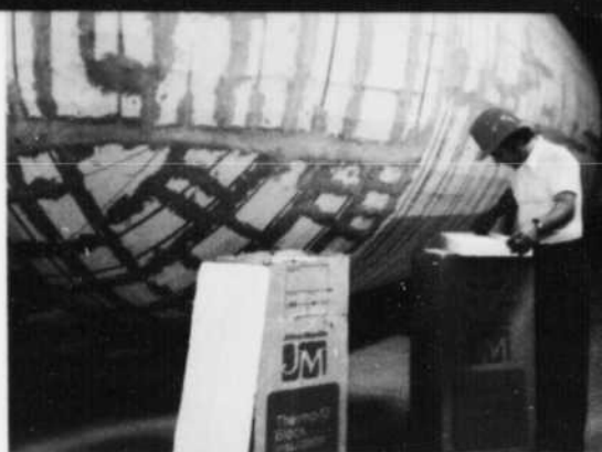
On a revêtu d'isolant en bloc Thermo-12 ce réservoir de condensation long de 122' à la centrale électronucléaire Bruce.
