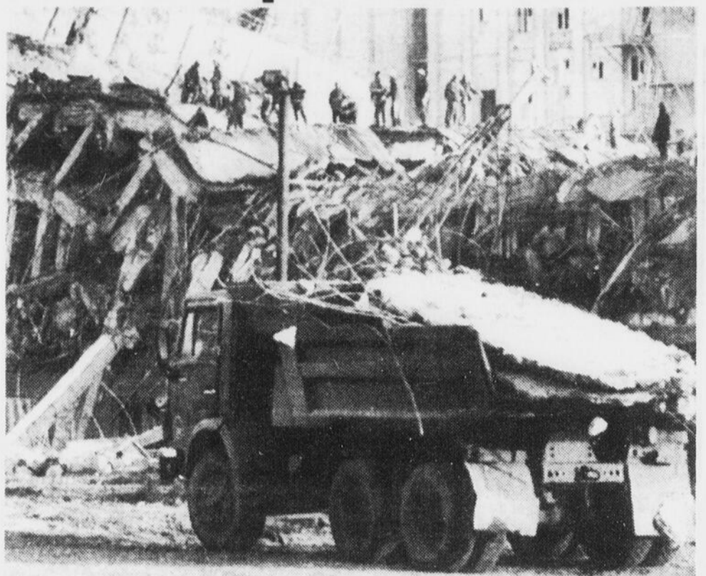
TRAVAIL — Des travailleurs démontent minutieusement un édifice dans la ville de Spitak en Arménie. Le building s'est effondré comme château de cartes lors du tremblement de terre qui a fait 23,700 victimes.
