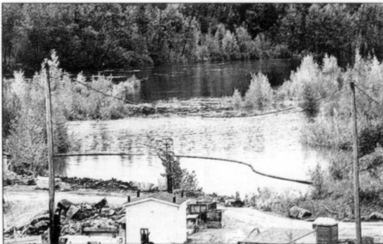
Une partie du chantier de la centrale de Pont-Arnaud a été inondé, ce qui a nécessité le déplacement de certains matériaux et équipements hier matin.
