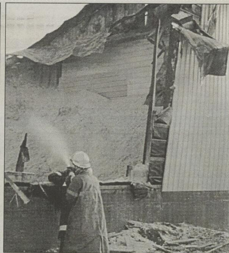
Les pompiers ont dû arroser copieusement pour s'assurer que les flammes ne renaissent pas de cet amas de bran de scie.
