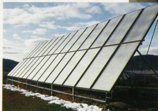
La ferme fonctionne partiellement à l'énergie solaire.
