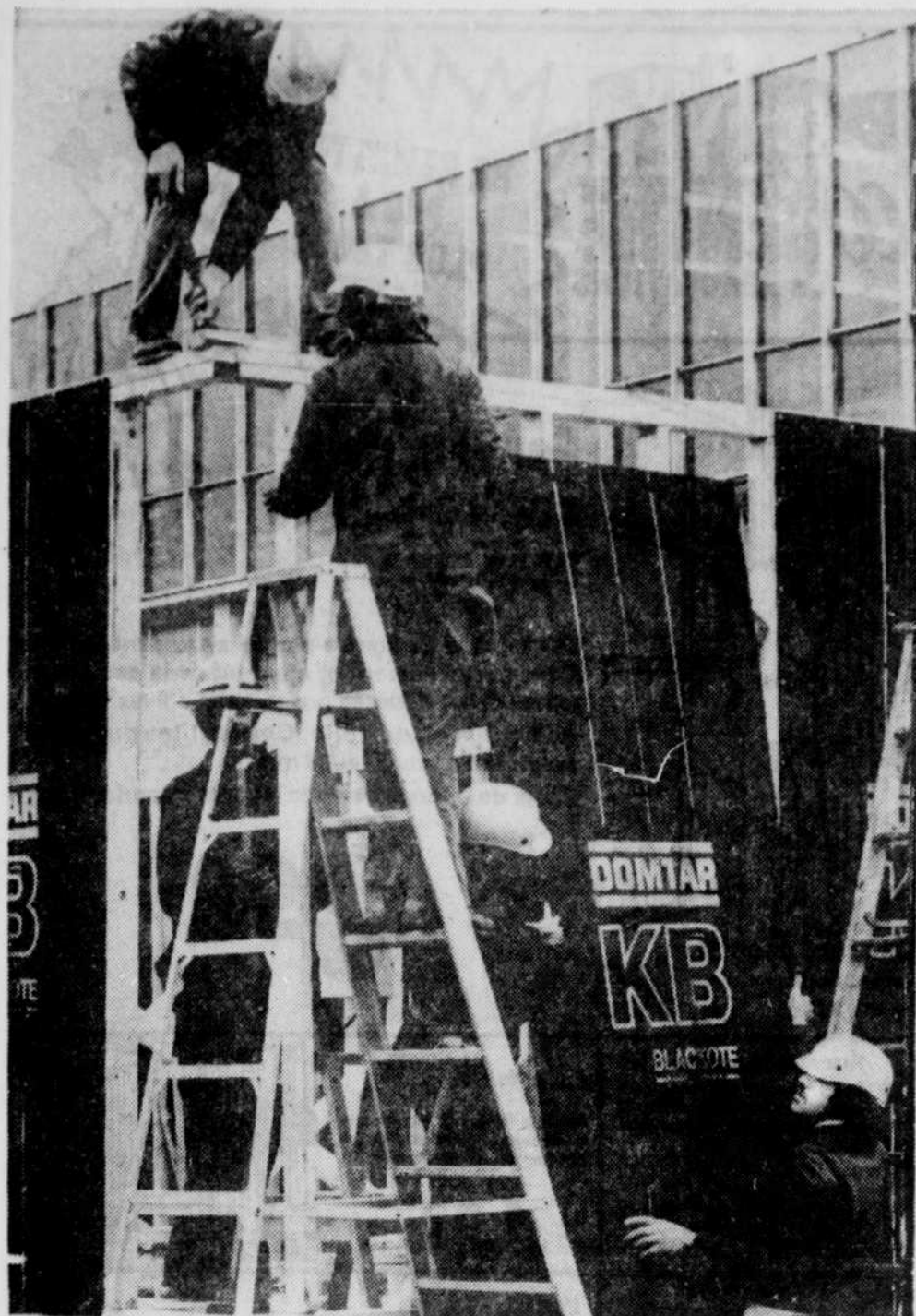
A l'arrière de l'École d'enseignement professionnel d'Asbestos, des étudiants de cette institution ont entrepris la construction d'une maison qu'ils espèrent par ailleurs vendre. (Photo La Tribune, Asbestos, par Marc-André Vachon)
