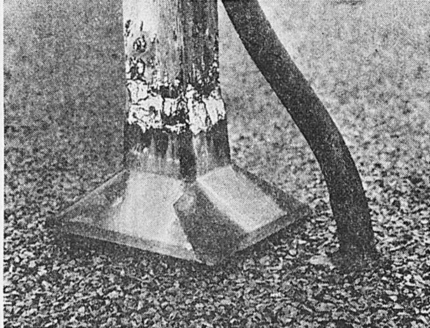
Ce joint de mastic à la base de ce poteau devra bientôt être reconstitué, sinon il ne faudra pas trop s'étonner des infiltrations d'eau qui pourraient survenir de ce côté.
