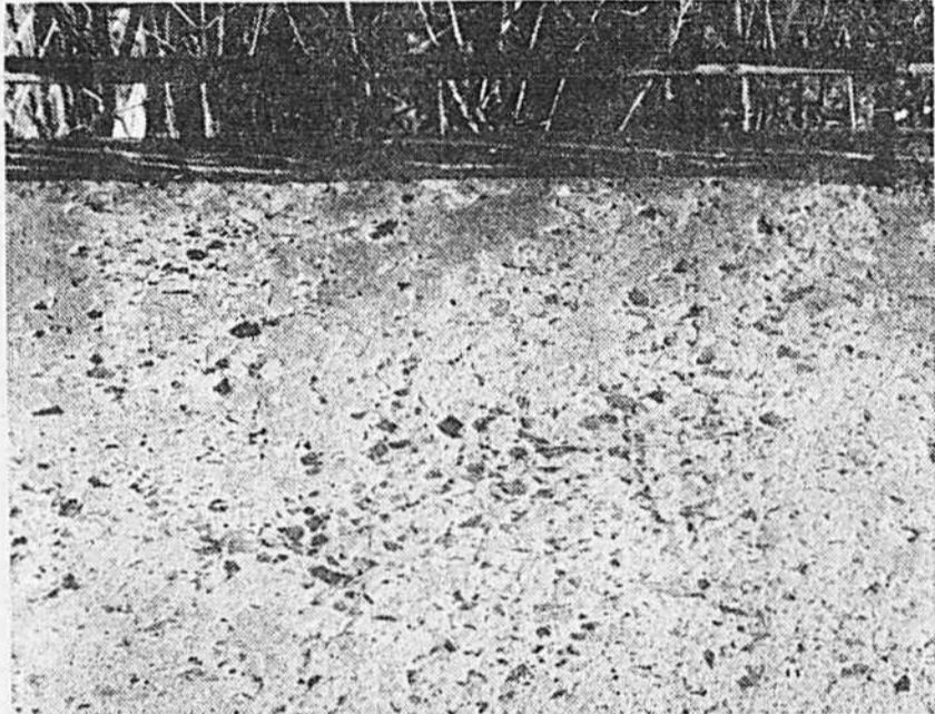
Gels et dégels ont laissé de profondes cicatrices sur cette surface de béton qui n'était probablement pas de résistance suffisante pour demeurer insensible aux intempéries.
