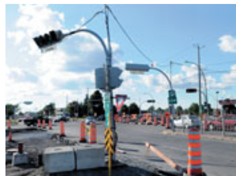
Les travaux majeurs réalisés à l'intersection du chemin de Chambly et du boulevard Jacques-Cartier, dans l'arrondissement du Vieux-Longueuil, devraient être terminés au mois de novembre.
