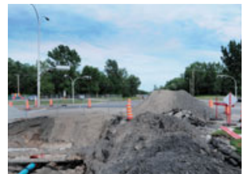
Les travaux majeurs réalisés sur le boulevard Davis, dans l'arrondissement de Saint-Hubert, devraient aussi être terminés au mois de novembre.
