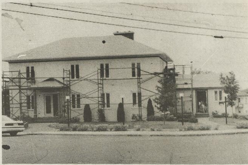
Située au coeur du village dans un axe achalandé, la bâtisse se refait une beauté afin d'être mieux adaptée à ses nouvelles fonctions.
