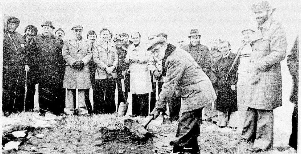
Le maire de Saint-Pascal, M. Ernest Ouellet, lève la première pelletée de terre donnant ainsi le coup d'envoi du début des travaux de construction des 50 unités de logement H.L.M. pour personnes âgées à Saint-Pascal.
