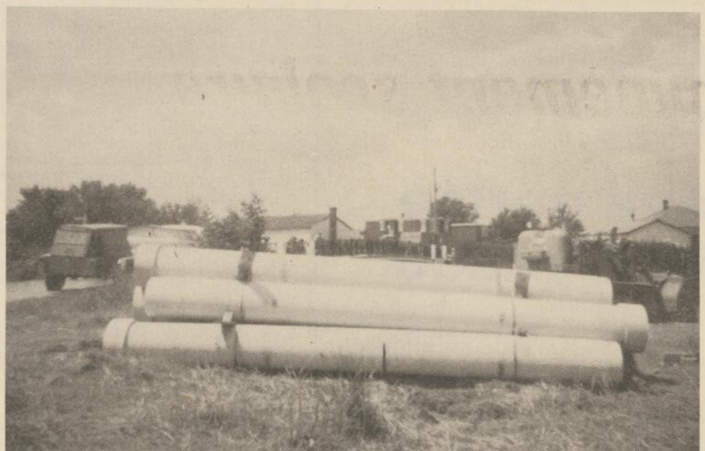
La pose des tuyaux d'aqueduc et d'égout, au pont Bonnette, est en bonne voie de réalisation. Il s'agit là de la phase II de l'intercepteur Yamaska-est.
