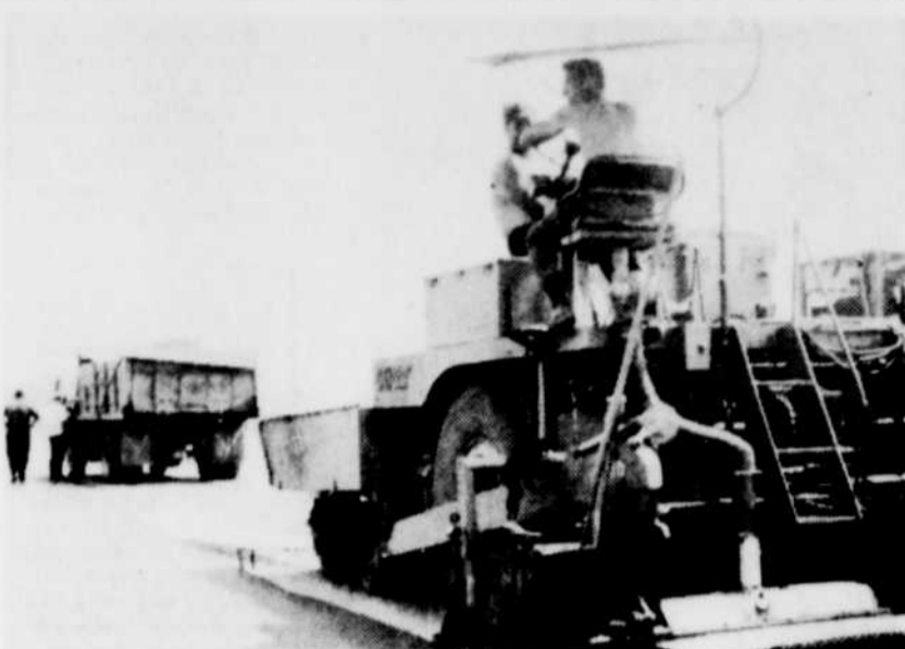
RUE LABBÉ — La Voirie municipale effectue des travaux sur la rue Labbé, dans la courbe où tout dernièrement un accident mortel s'est produit. On avait par la suite constaté le danger que présentait cette courbe. Son élargissement la rendra beaucoup moins dangereuse. (Photo La Tribune, Victoriaville)
