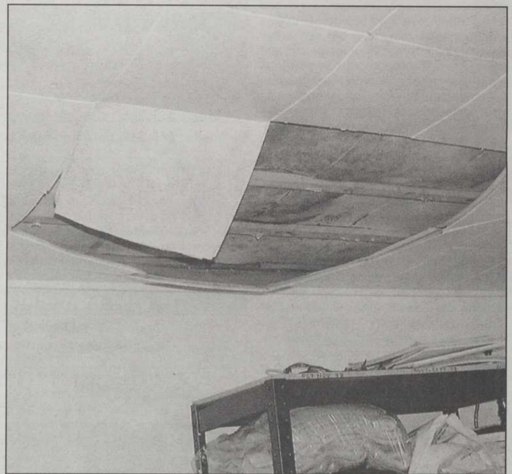
Si votre plafond a été endommagé par la pluie, prévenez votre assureur.
