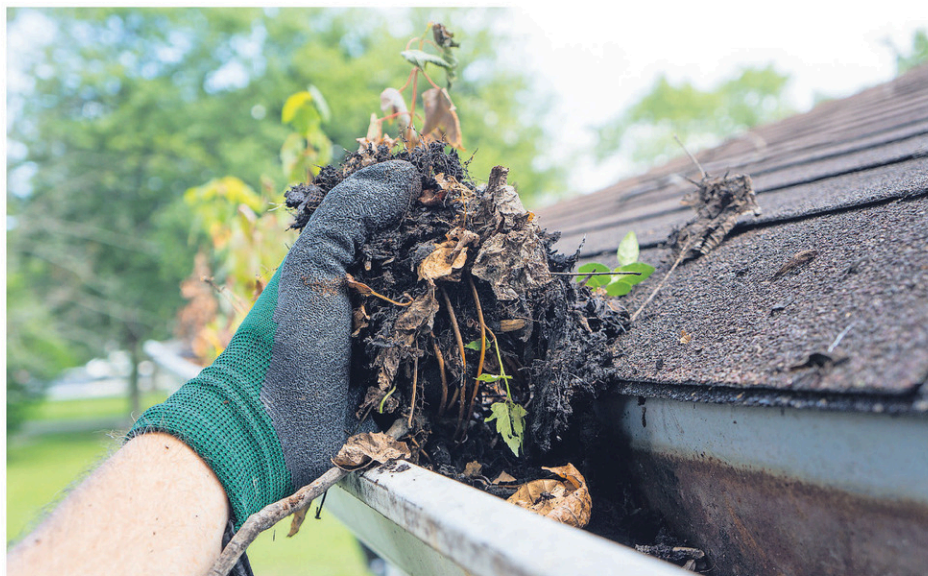
Vérifiez si les gouttières ne sont pas obstruées par la présence de débris ou de feuilles mortes. (Photo Deposit)
