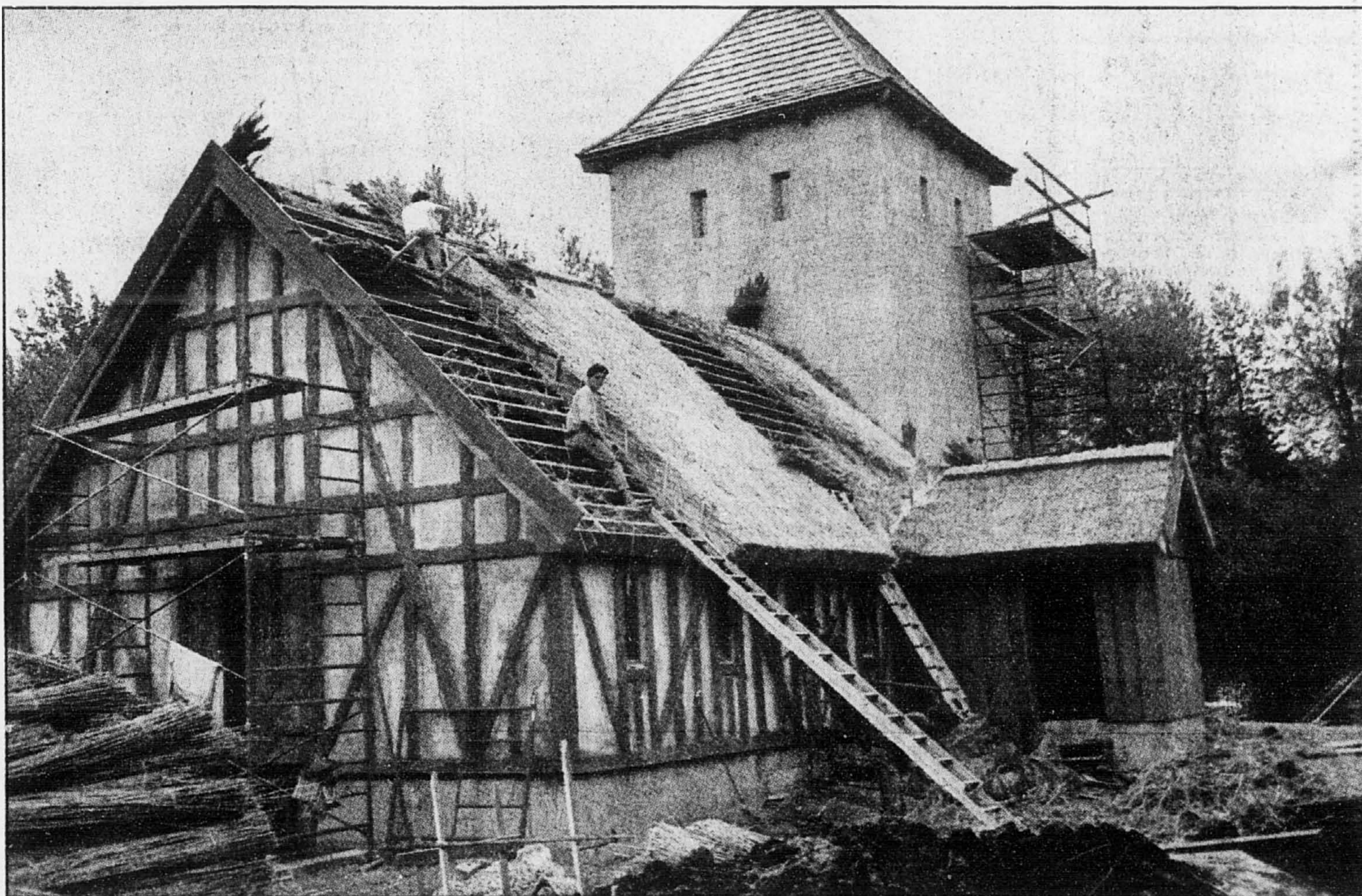
Nos deux jeunes chaumiers travaillent à couvrir l'église du village de Shehaweh.
