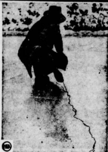
L'eau printanière est la grande responsable des crevasses qui ruinent les routes et le contribuable.
