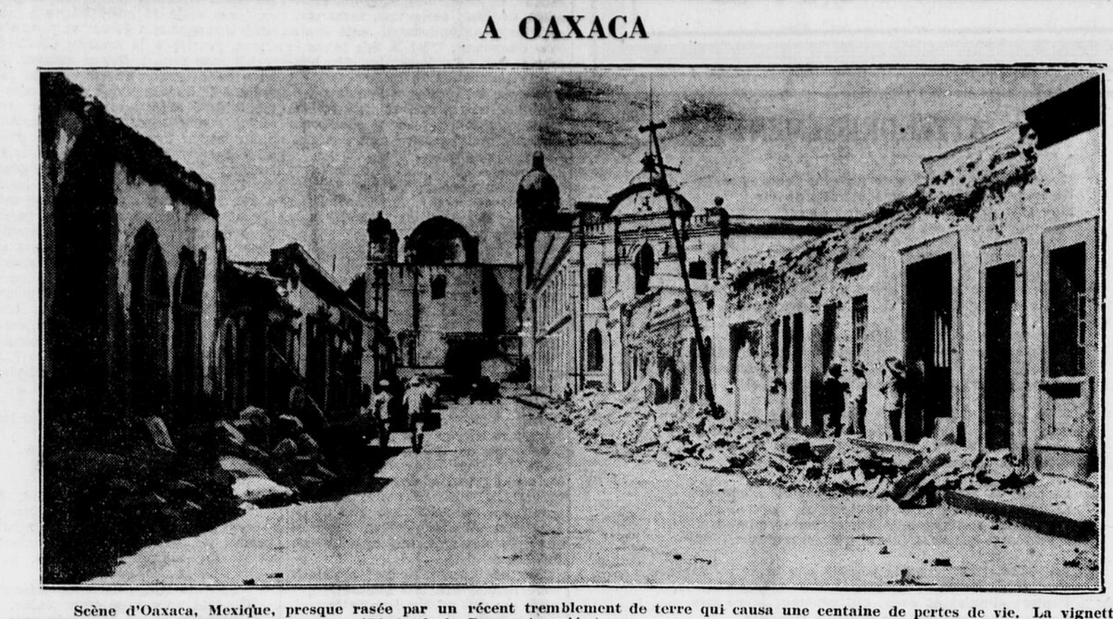
Scène d'Oaxaca, Mexique, presque rasée par un récent tremblement de terre qui causa une centaine de pertes de vie. La vignette représente une vue générale des dommages. (Photo de la Presse Associée.)
