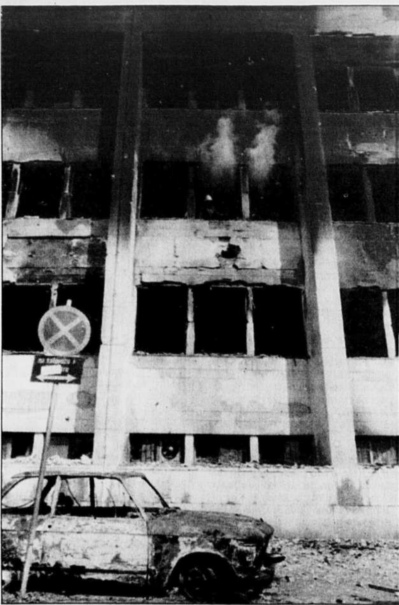
Un pompier, au troisième étage d'un édifice, évaluait hier les dégâts causés par des bombardements sur Sarajevo.
