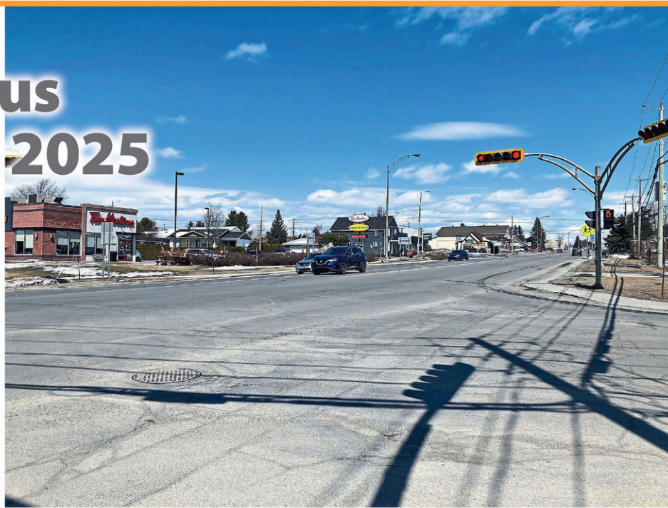
Des travaux d'asphaltage sont prévus sur la route 112 entre la rue St-Désiré dans le secteur de Black Lake et la rue du Coteau près de Nissan Thetford.
