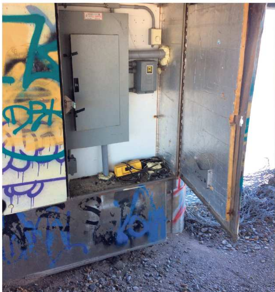
Un panneau électrique qui a été forcé.
