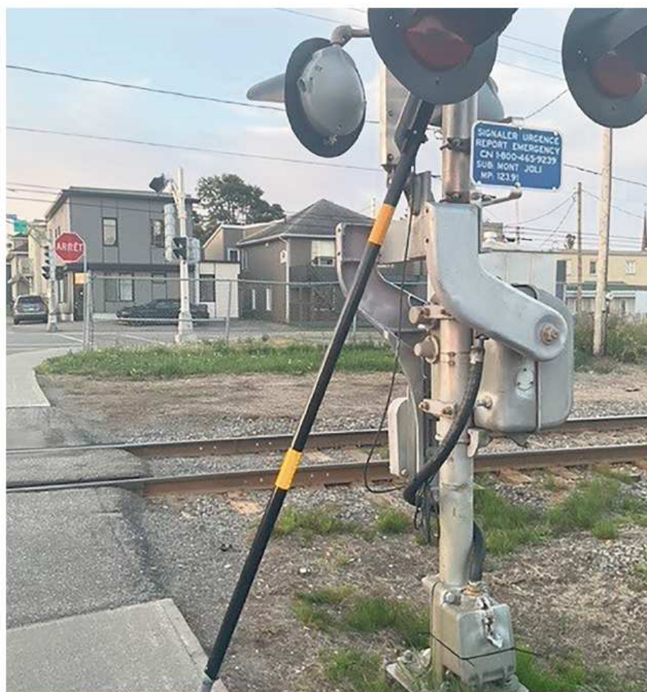
Chaque année, les actes de vandalisme coûtent entre 55 000 $ et 75 000 $ en réparation et plus de 1 000 heures de travail sont nécessaires pour réparer les dommages.
